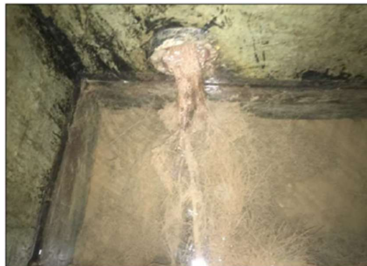
Obrázek 6: Šachtice II stav před čištěním (kořeny vyčnívající z jímacího zářezu)
